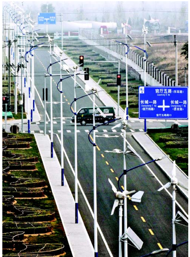
ระบบไฟถนนเสริมเต็มระหว่างพลังลมและพลังแสงบนถนนทางส่วนหนึ่งของอำเภอเหยงชิงกรุงปักกิ่ง 延庆县部分街道上安装的风光互补路灯系统
