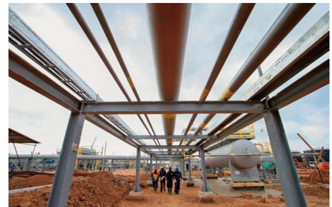
တည်ဆောက်ဆဲဖြစ်သော တန်ဇန်နီးယားနိုင်ငံရှိ မူထဝါရာသဘာဝဓာတ်ငွေ့စက်ရုံ 在建中的坦桑尼亚姆特瓦拉天然气处理厂 新华社图
